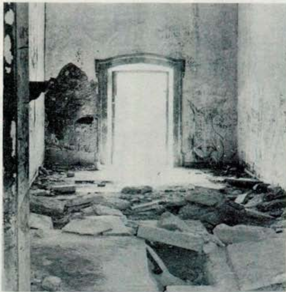
A IGREJA DE S. PAULO ENCONTRA-SE EM ESTADO DE DEGRADAÇÃO TOTAL.
