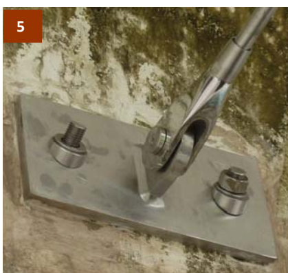
Fig.1 e Fig. 2: Imagem de Tirantes Colapsados e tirantes novos em aço inox, respectivamente, localizados no interior do claustro, alçado virado a nascente. Fig.3 e Fig.4: Imagem de tirantes colapsados e tirantes novos em aço inox, respectivamente, localizados no interior do claustro, alçado virado a norte. Fig.5: Chumbadouro, com orelha para fixação de forquilha acopolada a tirante. Fig.6: Placa terminal de ancoragem com aperto pelo exterior.
